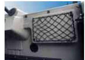
Le panneau des fusibles est situé dans la cabine, derrière le tableau de bord inférieur, du côté passager.
