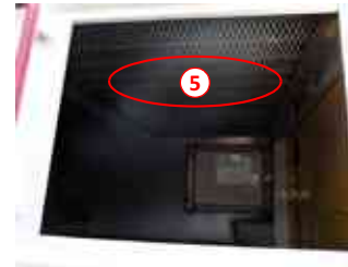
Zone vers laquelle diriger l'eau sur la crépine par la trappe d'accès latérale
