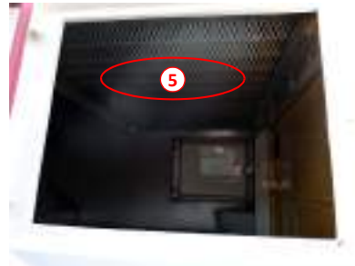
Área para direccionar a água para o crivo através da escotilha de acesso lateral
